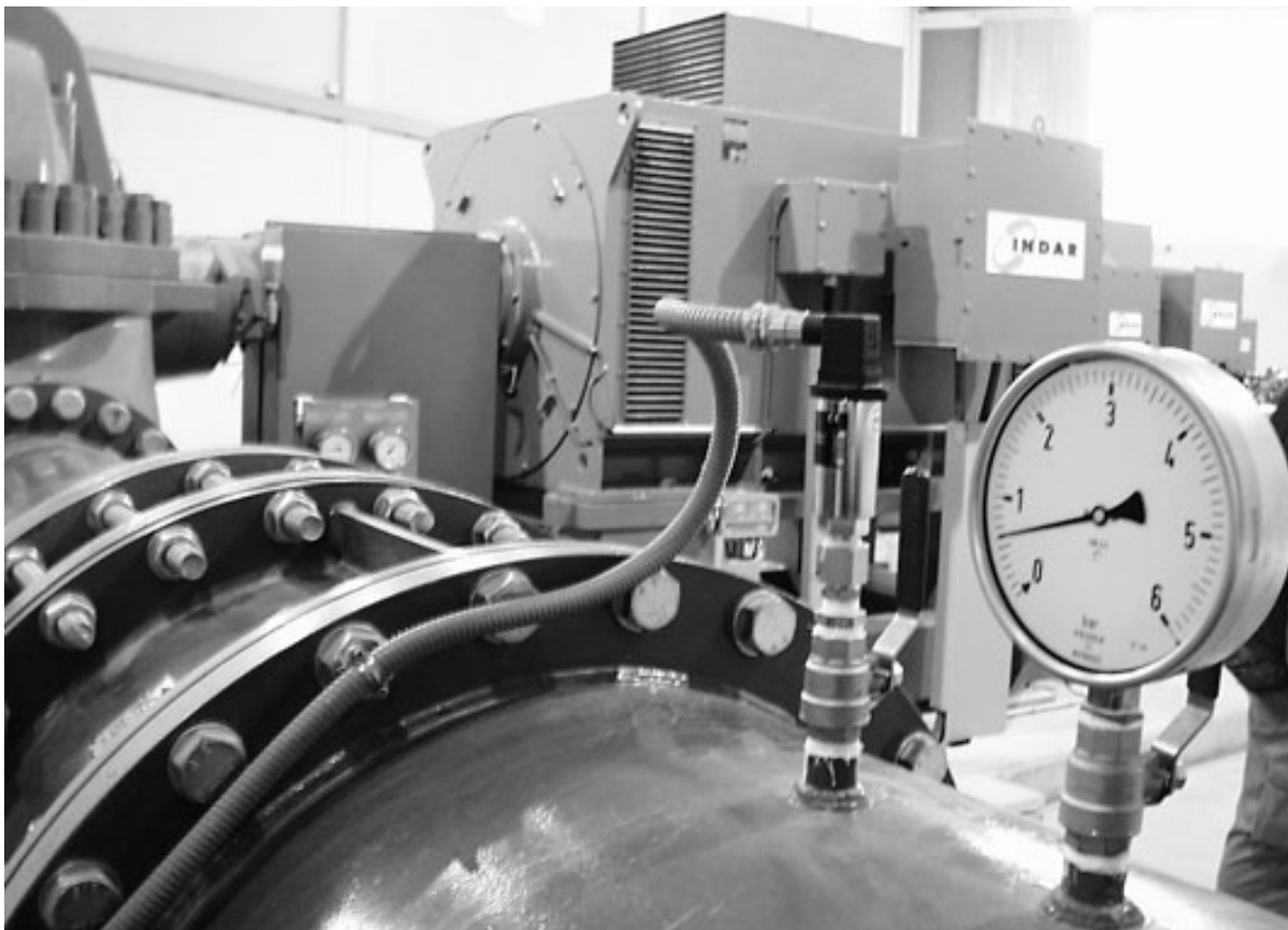
Estació central de bombament del reg de la Terra Alta, a la Poble de Massaluça. / J.P.
